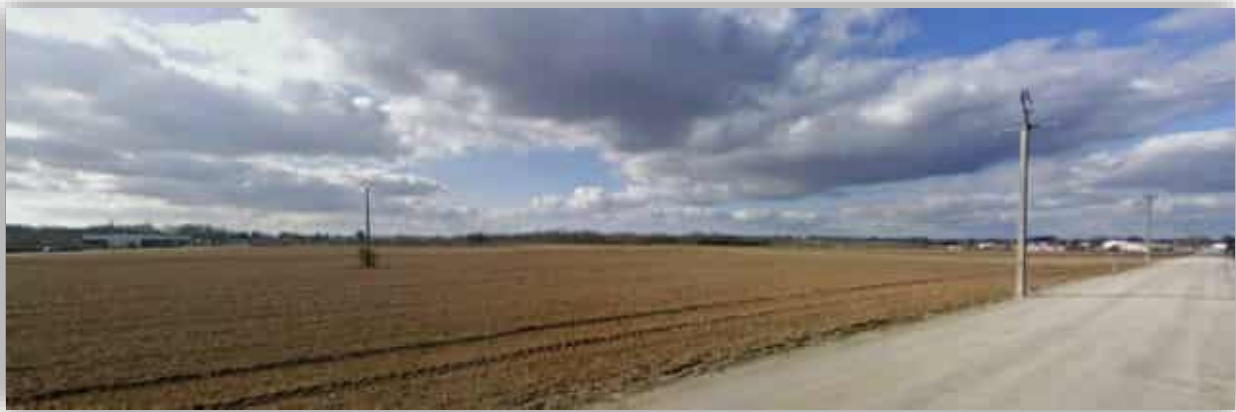
Ligne électrique traversant la parcelle 286
