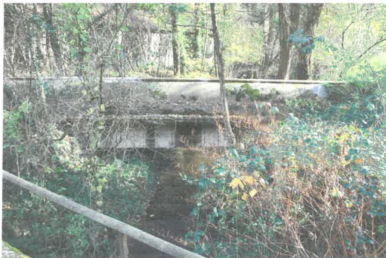
Petite Hurtière Conduite forcée entre Papeterie de Renage et Petite Hurtière
