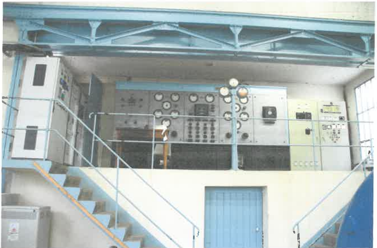
Petite Hurtière Au centre ancien tableau de commande restauré et conservé À gauche et à droite armoires de commande des 2 turbines Francis commande, régulation & surveillance, enregistrement production
