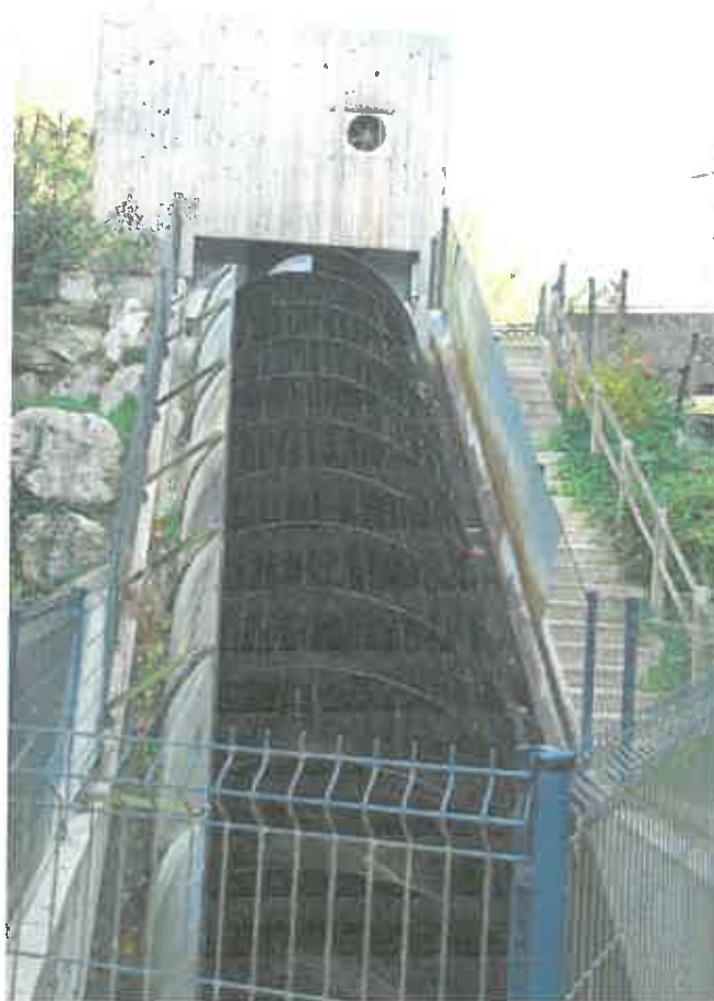
Papeterie de Renage - Vis d'Archimède
