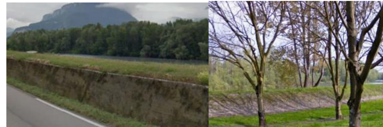
Digue de l'Isère à Veurey-Voroize (à gauche) et à la Rivière (rive gauche, à droite)
