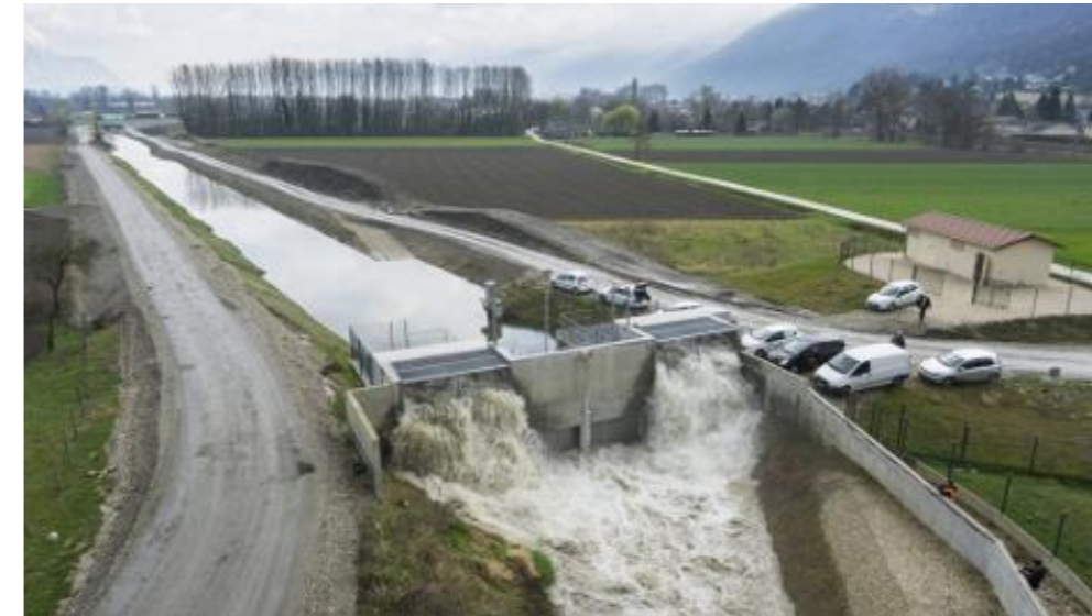
Essai de fonctionnement de la station de pompage de la Cheminade Printemps 2015 (Source : SYMBHI)
