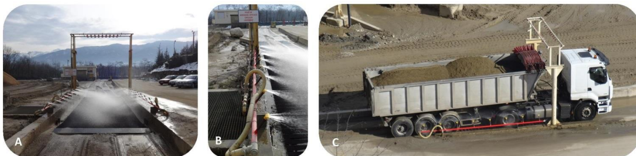
Illustrations du dispositif de lavage des roues présent en sortie de carrière du site de Barraux. De gauche à droite : (A) Le dispositif de lavage de roue s'active dès qu'un véhicule se présente à l'entrée du dispositif ; (B) Zoom sur le dispositif de lavage des roues ; (C) Passage d'un camion au niveau du dispositif de lavage des roues. Photo : 2015 - Granulats VICAT.
