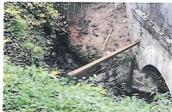
Vanne à restaurer et manœuvrer en cas de besoin
