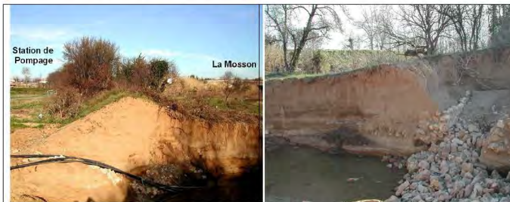
Figure 2.32 – Digue de la Mosson après la rupture : câbles mis en place dans la tranchée et restes de l'ancienne fondation – Source Cerema.
