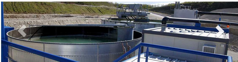
exemple d'installation : système de recyclage des eaux de lavage de l'installation de traitement des matériaux de la carrière de Palenge à ARANDON (source : site internet de l'entreprise)
