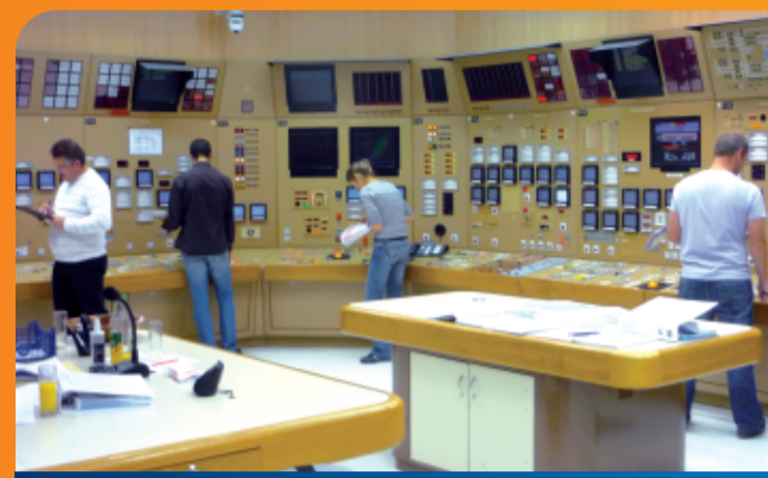
Un simulateur de la salle de commande permet de s'entraîner aux situations accidentelles les plus improbables.
