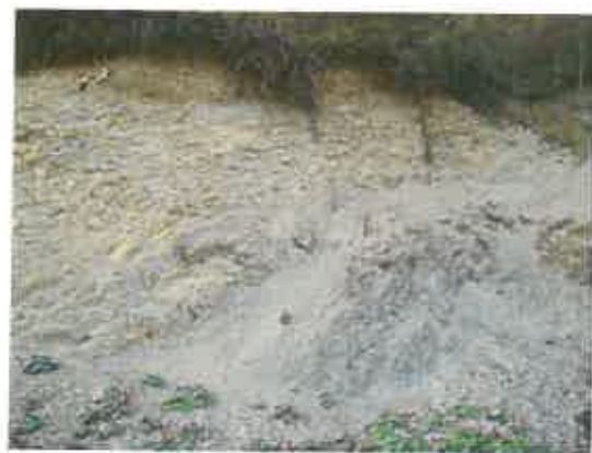
• 16. Micro-plissements et contact faillé anormal sur le front du glissement de Narbonne.
