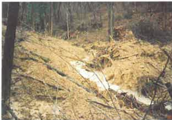
• 29. Glissement de janvier 1995 : arrivée de la coulée dans le Souchet.
