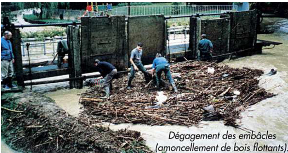
Dégagement des embâcles au niveau des anciennes vannes du Clos-St-Georges en crue – St-Symphorien d'Ozon
