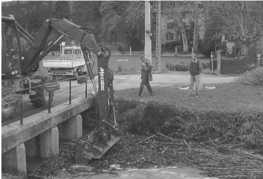
Travaux d'enlèvement des embâcles après la crue de novembre 2002 au niveau du pont sur l'Ozon, rue de l'Ozon
