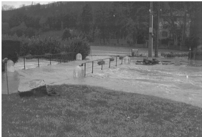
crue de novembre 2002 sur l'Ozon à Sérézin-du-Rhône – surverse sur l'ouvrage
