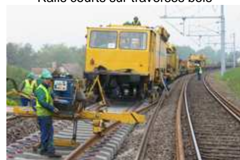
Longs Rails soudés sur traverses béton
