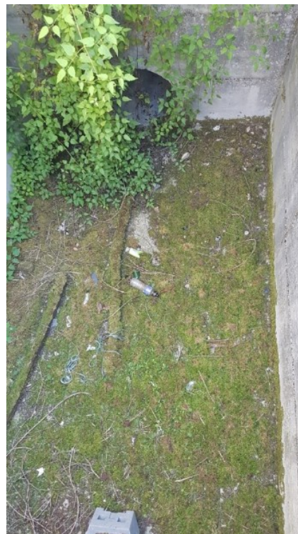
Illustration 39 : Canalisations d'évacuation de la surverse du bassin de rétention de la Tour de Criel - Photographie AGC juillet 2019
