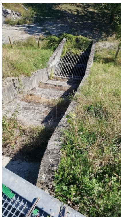
Illustration 38 : Surverse bétonnée et grille de récupération du bassin de rétention de la Tour de Criel - Photographie AGC juillet 2019
