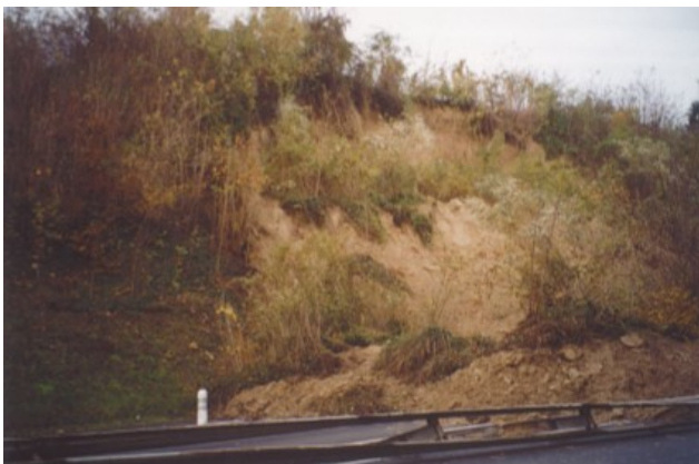
Illustration 42 : Glissement sur la RD75, 17/11/2002 - Photographie RTM
