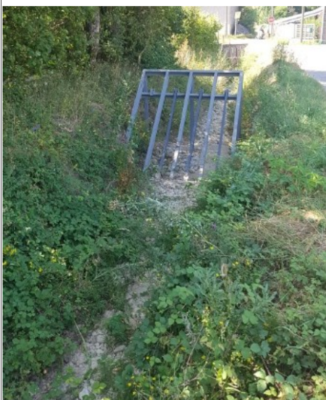
Illustration 8 : Grille piège à matériaux de la Vécrière - Photographie AGC juillet 2019
