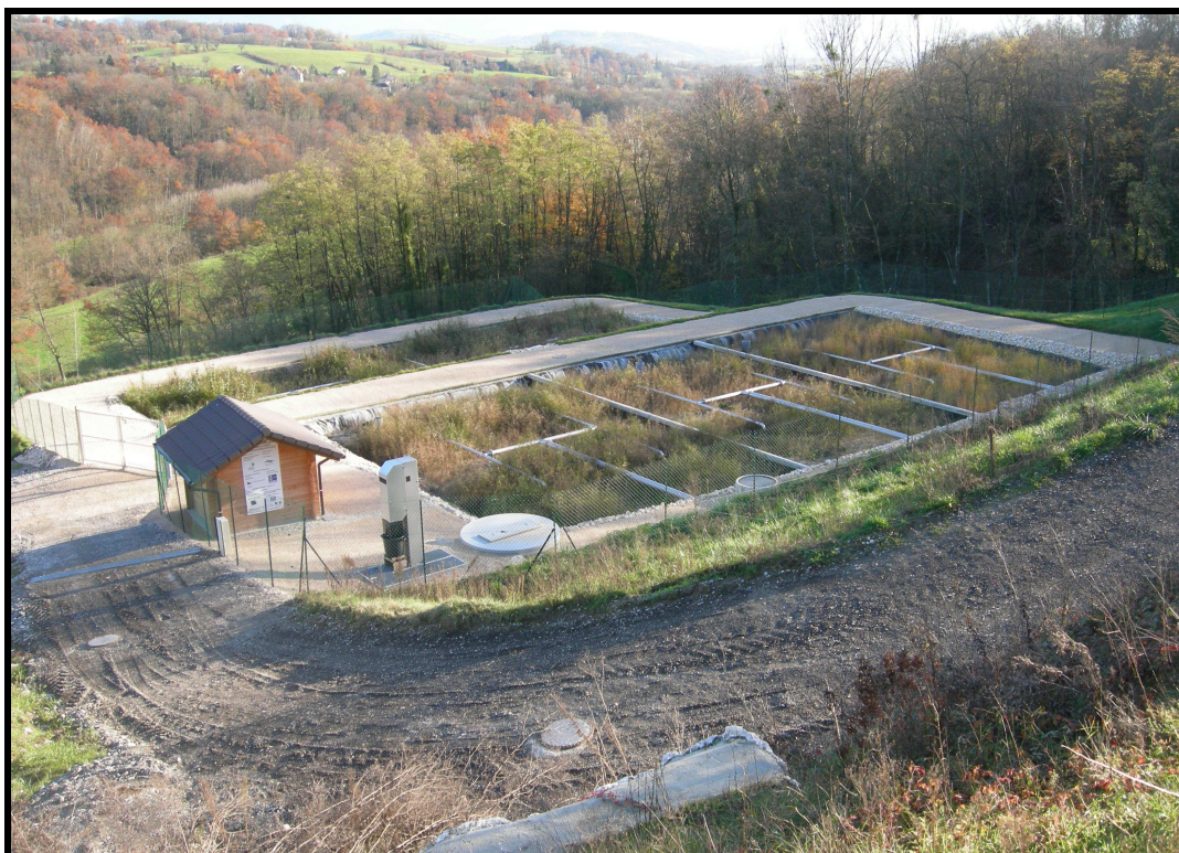
La station dans son ensemble, comprenant le dégrilleur et les 2 étages de lits à macrophytes
