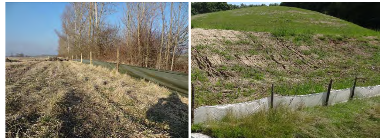
Figure 279 : Photographies de clôtures provisoires anti-intrusion pour la faune (© Egis / D. Ferreira)
