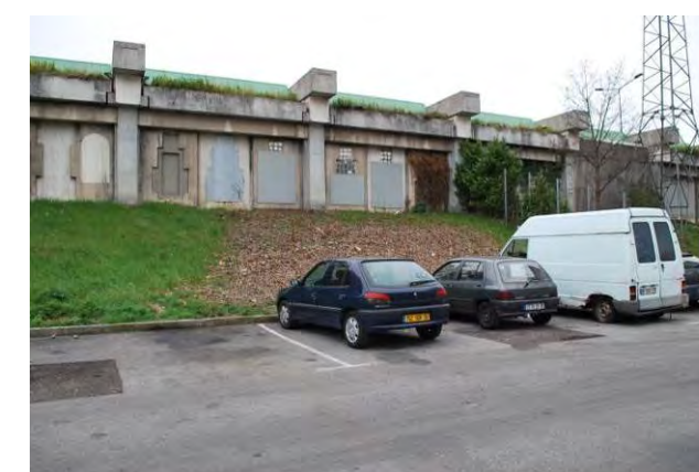
Figure 236 : Mur anti-bruit vue depuis la cité Mistral
