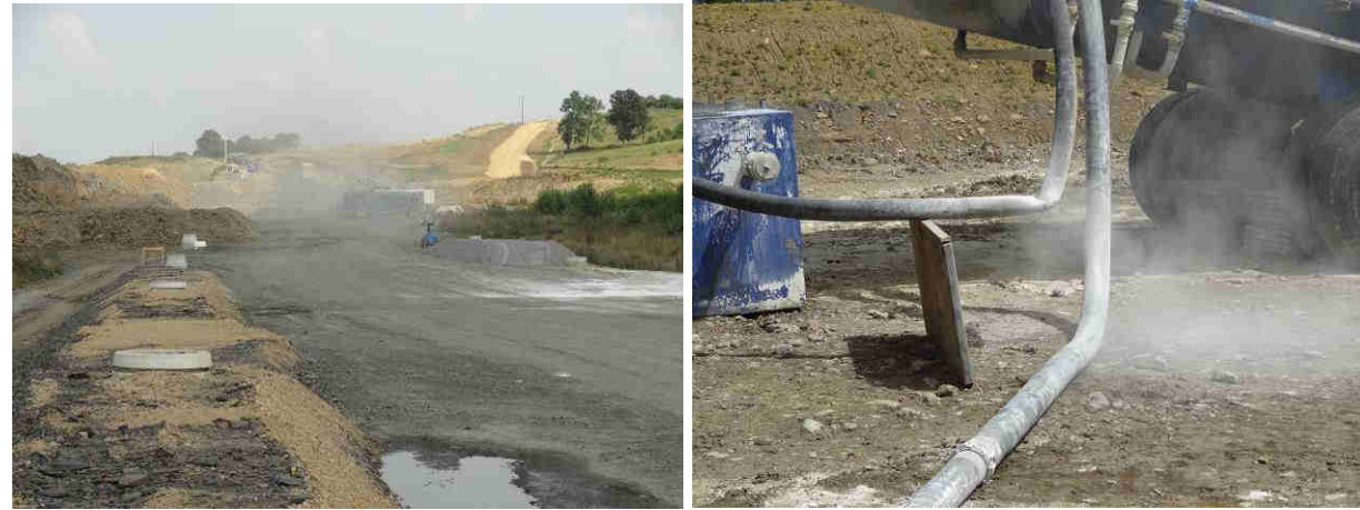
Figure 133 : Photographies d'envols de poussières sur chantier (© Egis / D. Ferreira)
