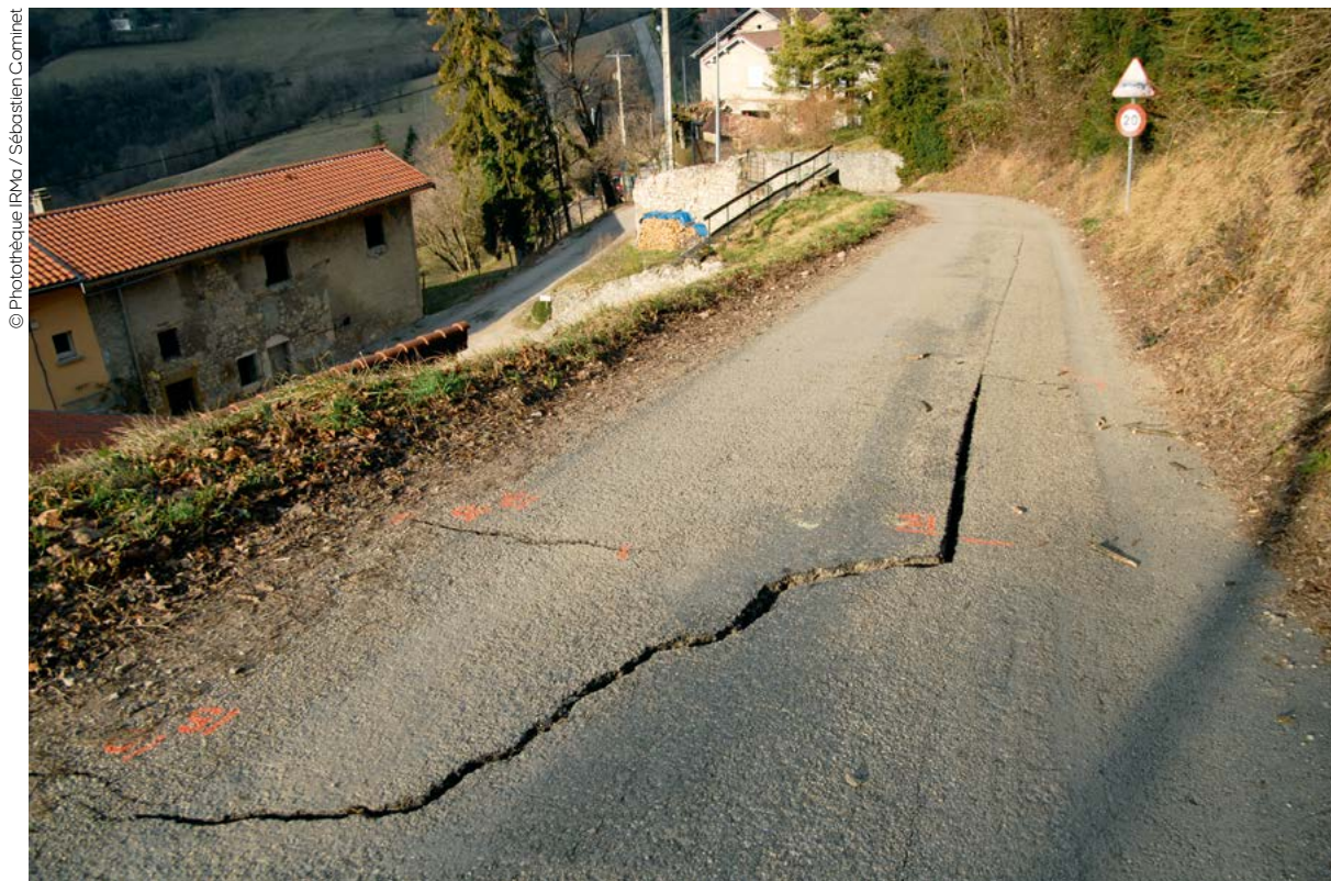
Saint-Martin-le-Vinoux - Affaissement de terrain dans le hameau du Mas Caché – Janvier 2011
