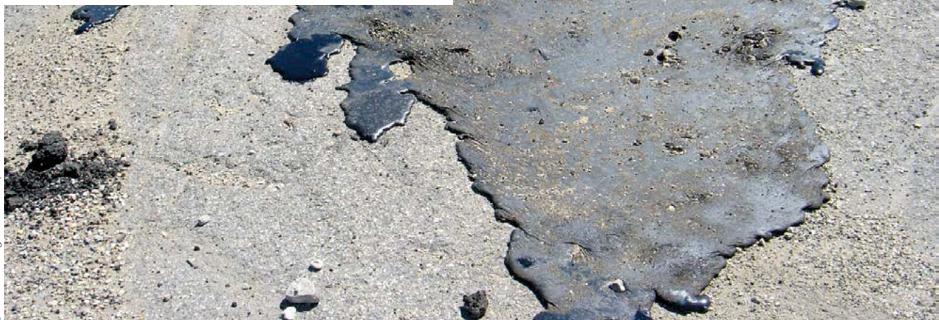
Présence d'hydrocarbure dans le sol
