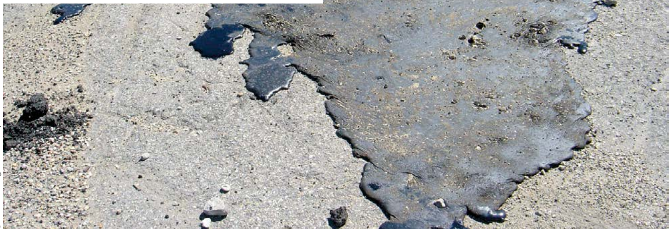
Présence d'hydrocarbure dans le sol
