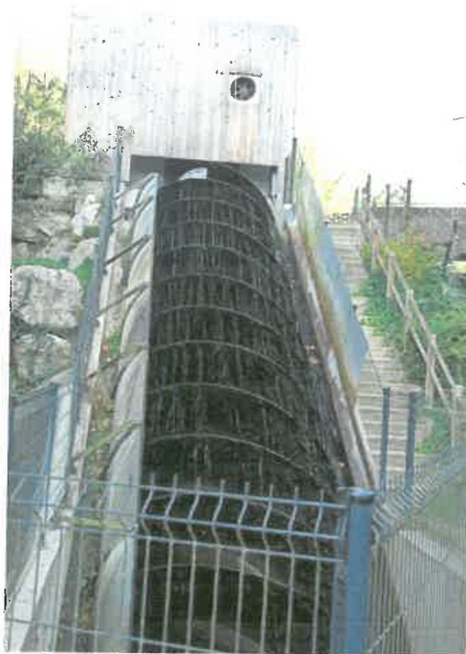
Papeterie de Renage - Vis d'Archimède
