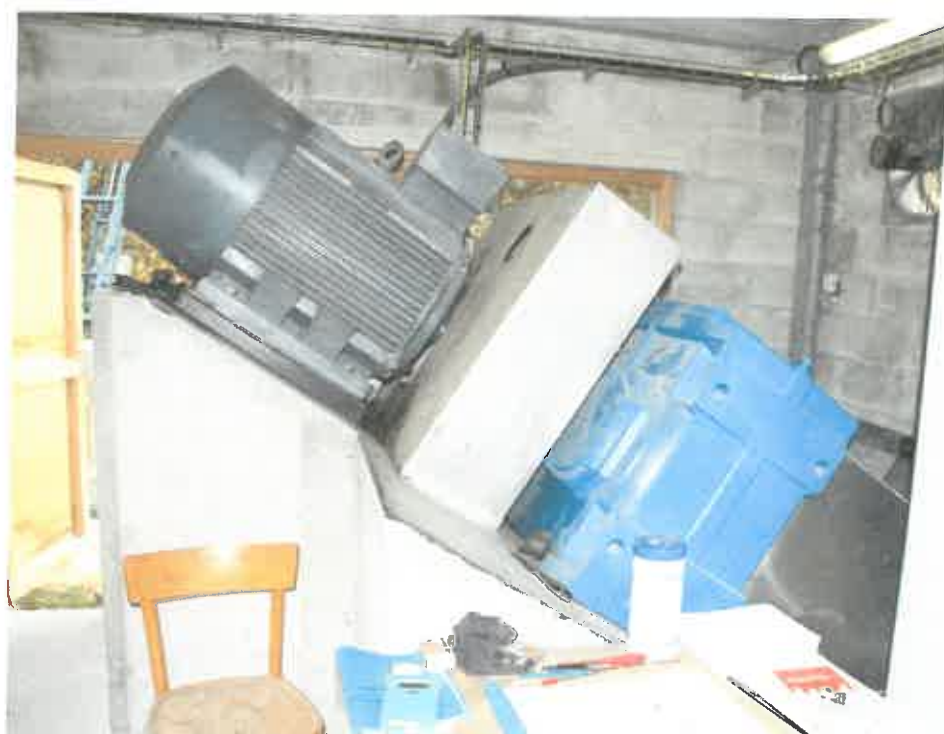
Papeterie de Renage – Alternateur de la Vis d'Archimède À droite, armoire de commande, régulation & surveillance, enregistrement production
