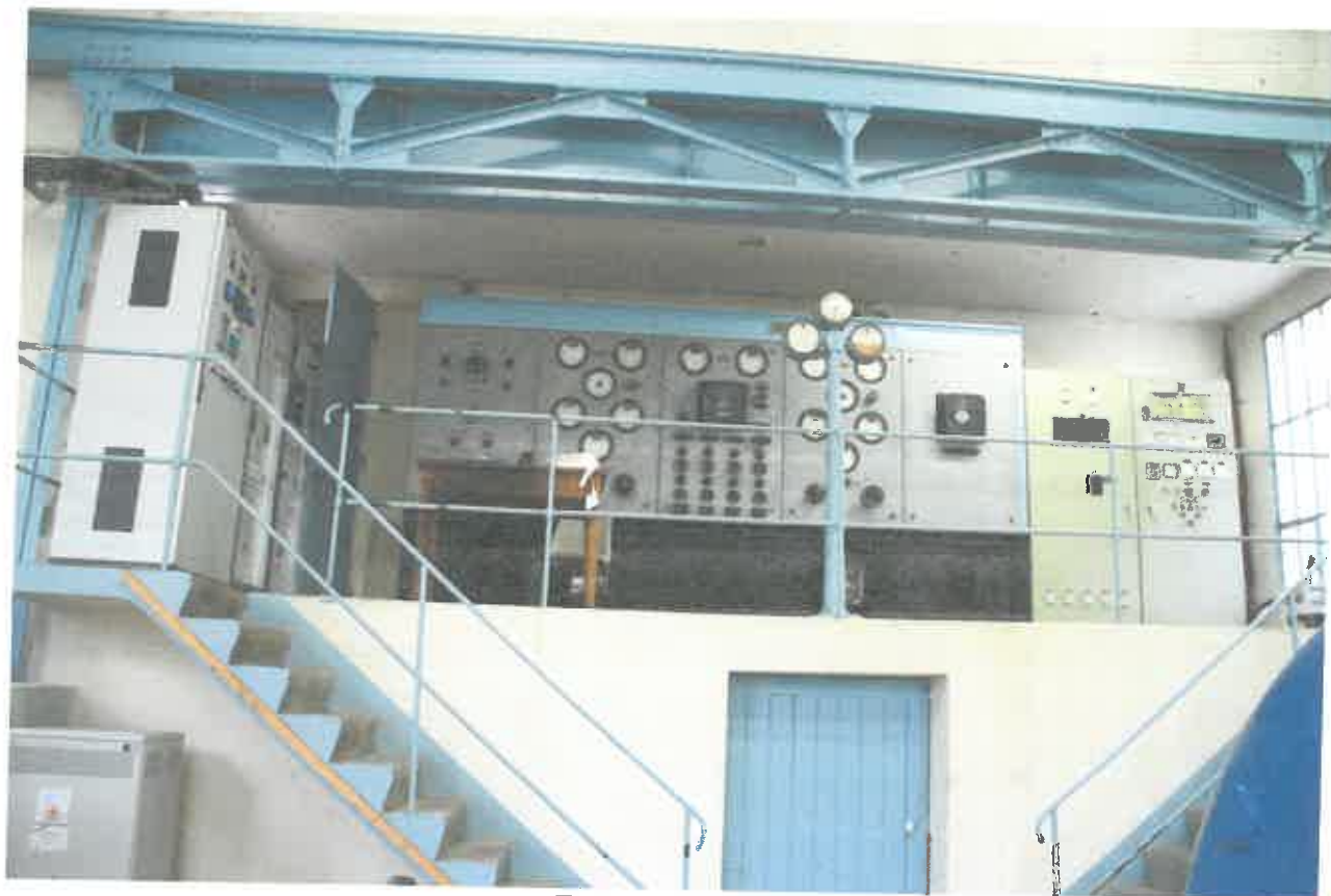
Petite Hurtière Au centre ancien tableau de commande restauré et conservé À gauche et à droite armoires de commande des 2 turbines Francis commande, régulation & surveillance, enregistrement production
