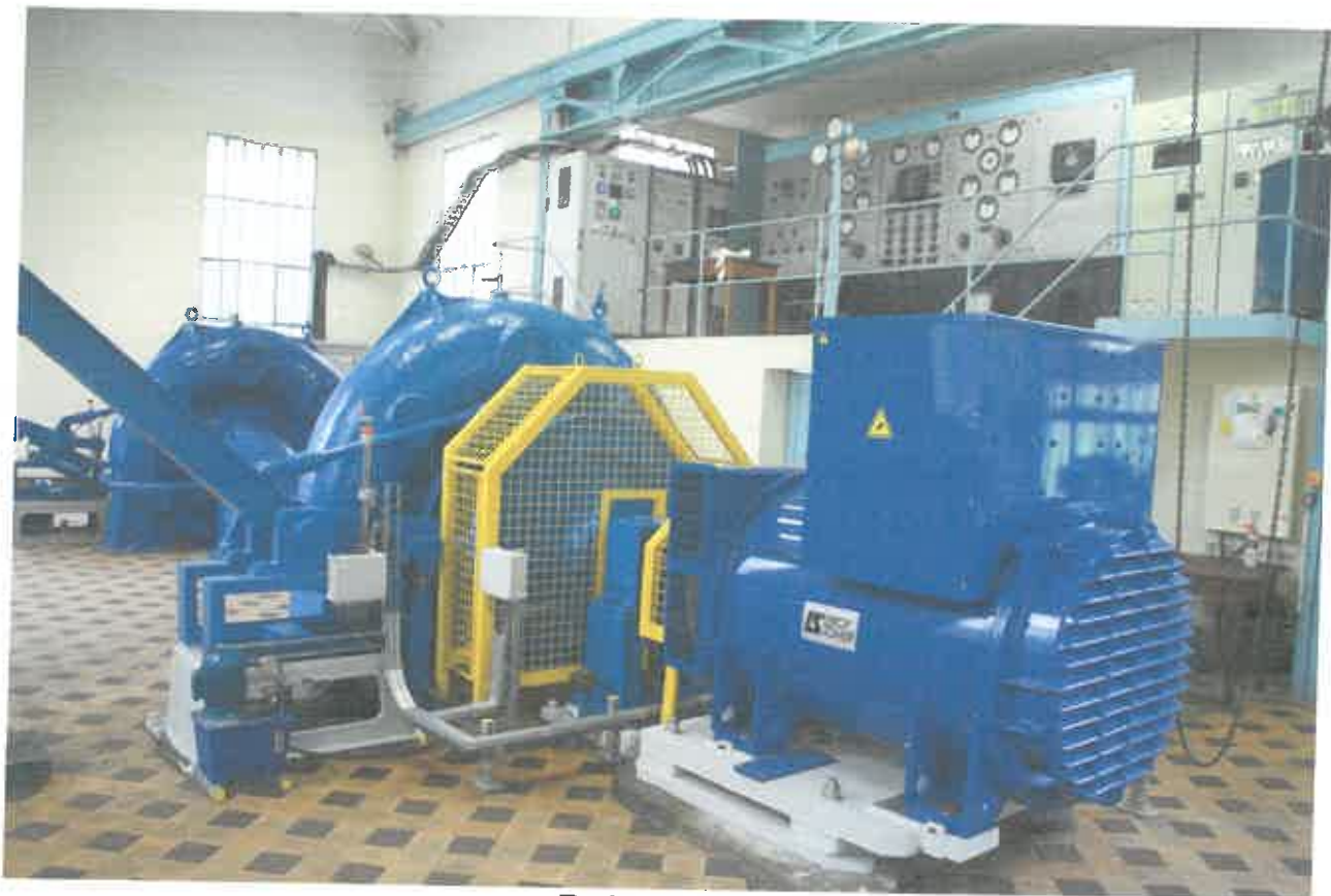
Petite Hurtière Vue d'ensemble des 2 turbines Francis et alternateurs
