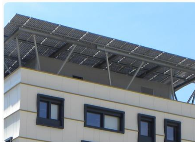
Panneaux photovoltaïques (Casernes de Bonne – Grenoble - 38)
